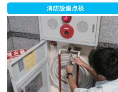
消防設備点検 消防用設備は、消防法により点検と点検結果の報告が義務付けられています。専任スタッフが責任を持って対応します。
