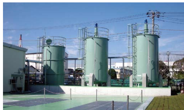
廃油・製品タンク
