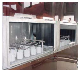
廃試薬処理設備
