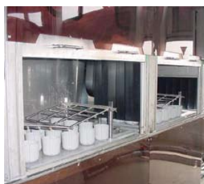
廃試薬処理設備
