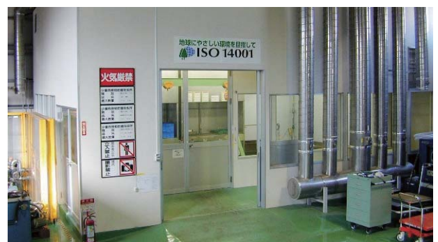
洗浄処理装置
