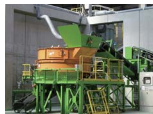
セメント原料製造施設
