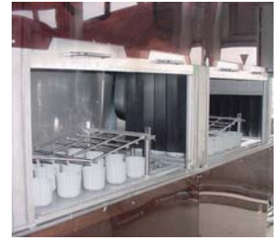
廃試薬処理設備
