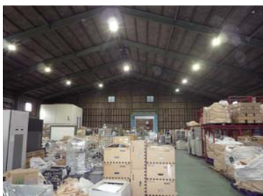
埼玉リサイクルセンターの高天井用LED照明
