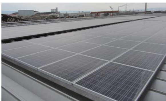
太陽電池モジュール (阪神事業所 尼崎工場屋上)
