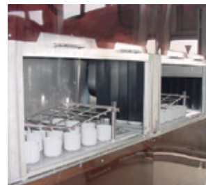
廃試薬処理設備
