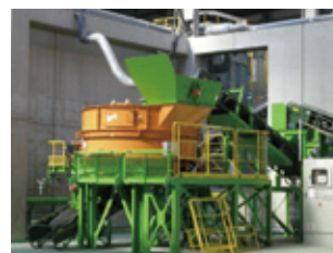
セメント原料製造施設
