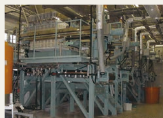
廃液処理施設
