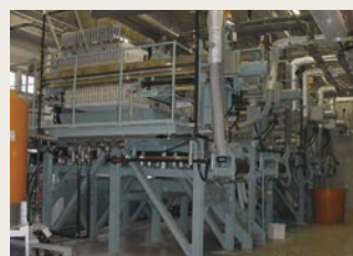
廃液処理施設
